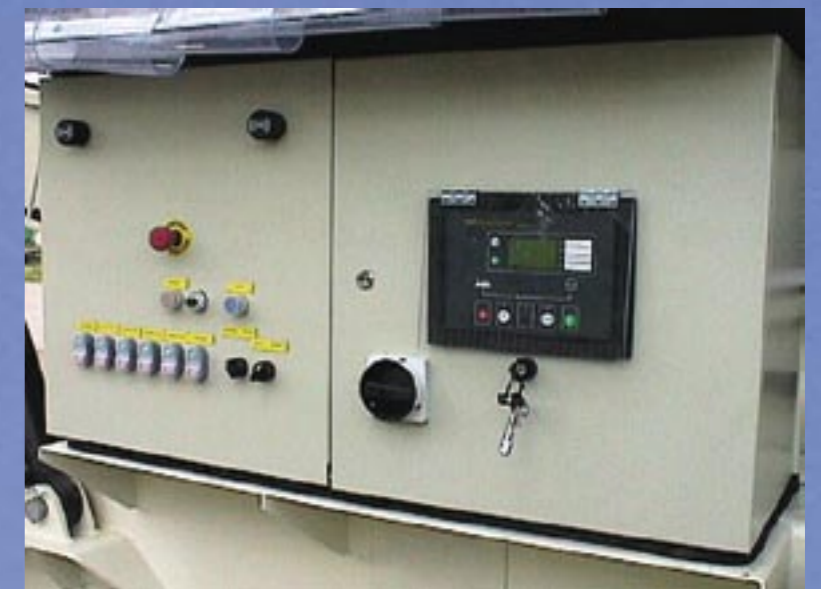
Centralt placerad elcentral med startpanel. Samtliga drifter är förreglade.
